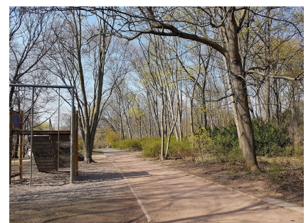
Ausspülungen an der Fitnessstrecke vor Projektbeginn
